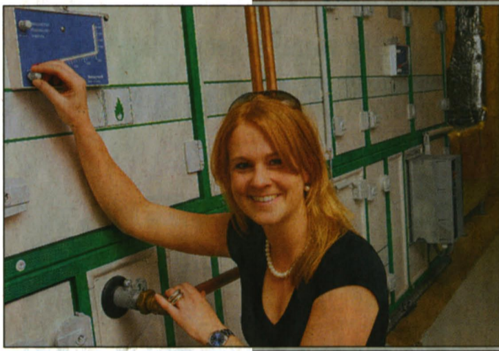
Wirtin Kerstin Schwan zeigt die versteckten Lüftungspower.
